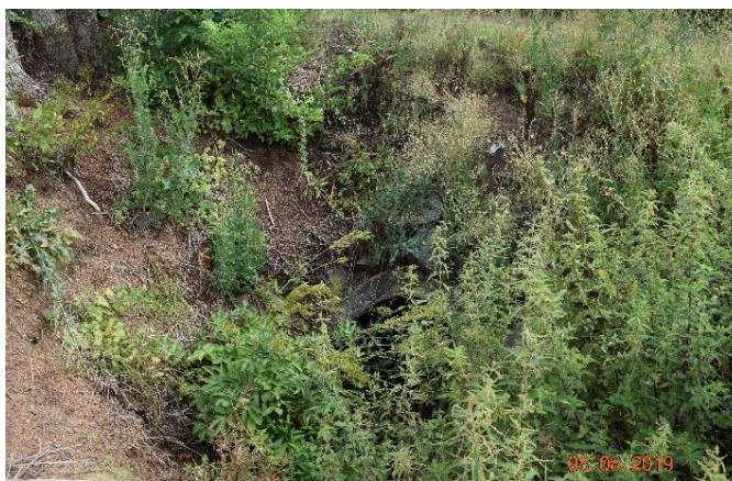
Einlass in die Verrohrung vor der Darscheider Straße
