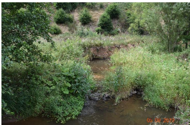
Erosion an der Böschung unterhalb der L 27
