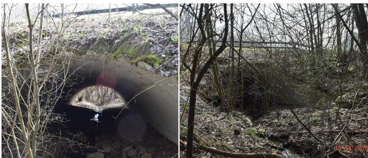
Abb. 8: Nadelwaldgraben am Durchlass Konrad-Zuse-Straße (in Fließrichtung)
