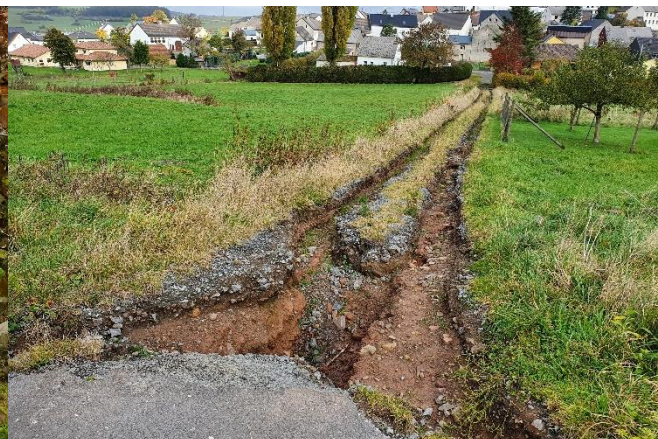
Zerstörter Wirtschaftsweg am Auslass des Dorfgrabens
