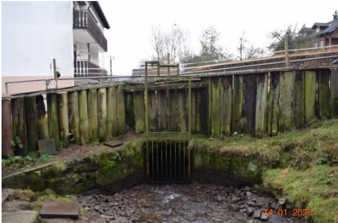
Einlassbauwerk in die Verrohrung: „Am Hippersbach 9A“
